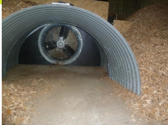
Ventilateur de séchage (extraction de l'air humide (Gesves-garage communal))
